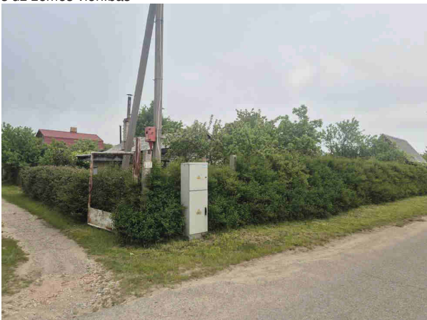
Elektrības pieslēguma vieta
